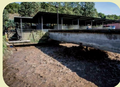
Trattamento biologico a fanghi attivi
